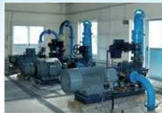
水源地から水をくみ上げ、配水池へ送水するポンプ
