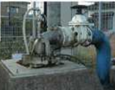
地下水源から水をくみ上げるためのポンプ
