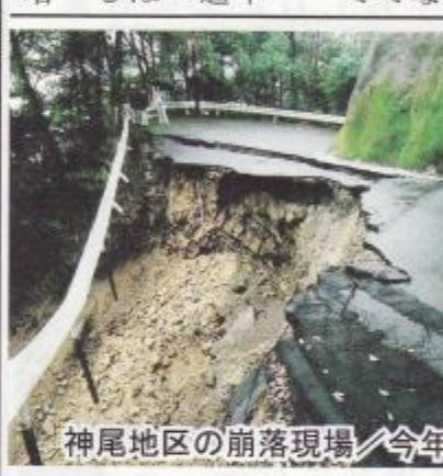
神尾地区の崩落現場/今年3月
